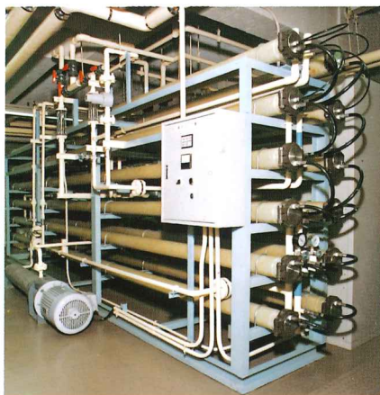
R/O逆浸透膜装置 10m 3 /時
